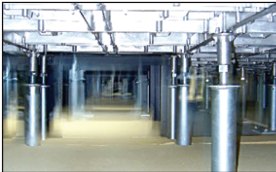
施工例：OAフロア床下断熱 (アイカ工業製接着剤でスラブに貼り付け)
